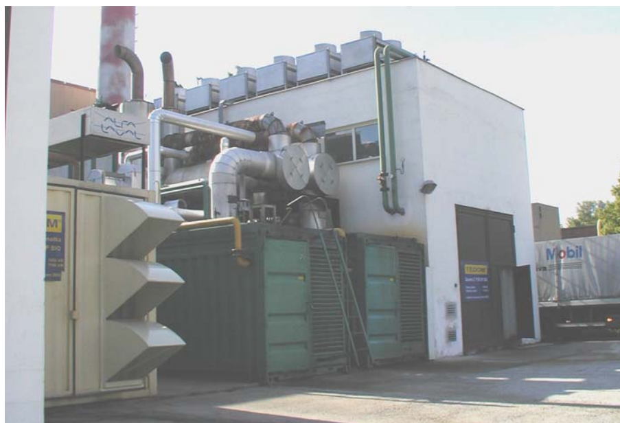
Obr. 5.10: Tři z původních KJ (2 x Jenbacher a 1 x TEDOM) jsou umístěny v ve venkovních kontejnerech, čtvrtá v budově po demontovaném plynovém kotli
