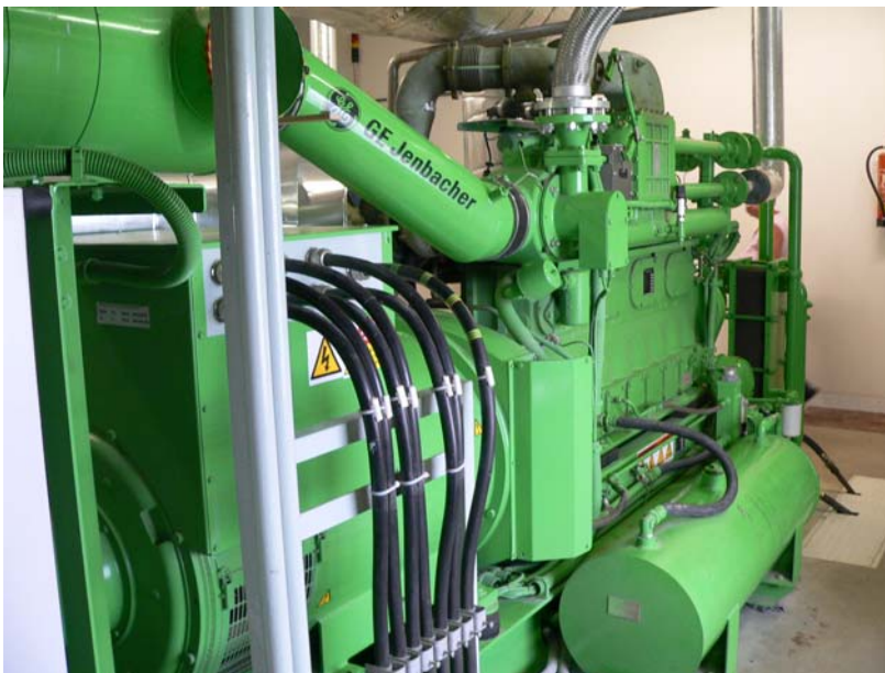
Obr. 3.5: Kogenerační jednotka fy GE Jenbacher
