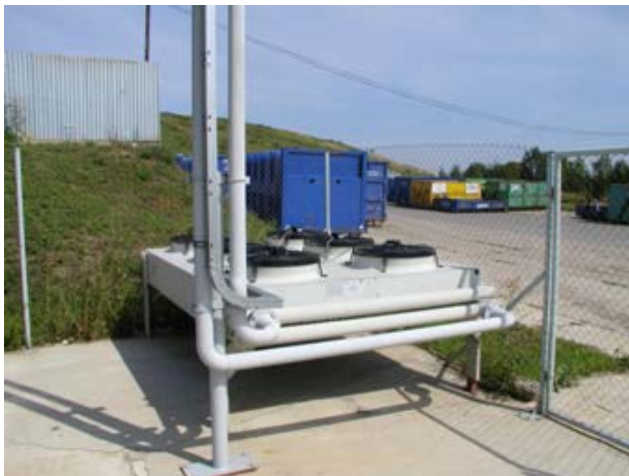
Obr. 5.9: Chladič v těsné blízkosti kogenerační jednotky
