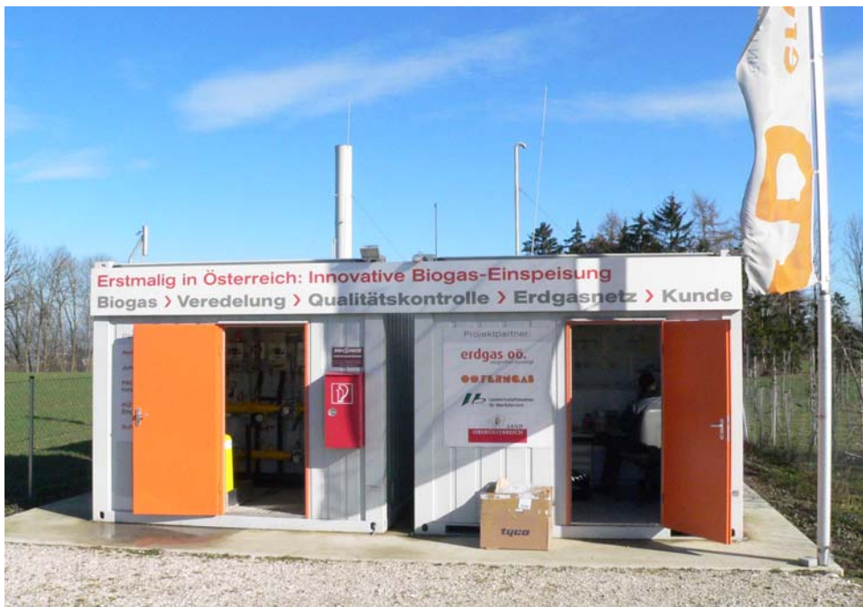
Obr. 3.6: Čisticí a stlačovací jednotka u menší bioplynové stanice v Puckingu (Rakousko)
