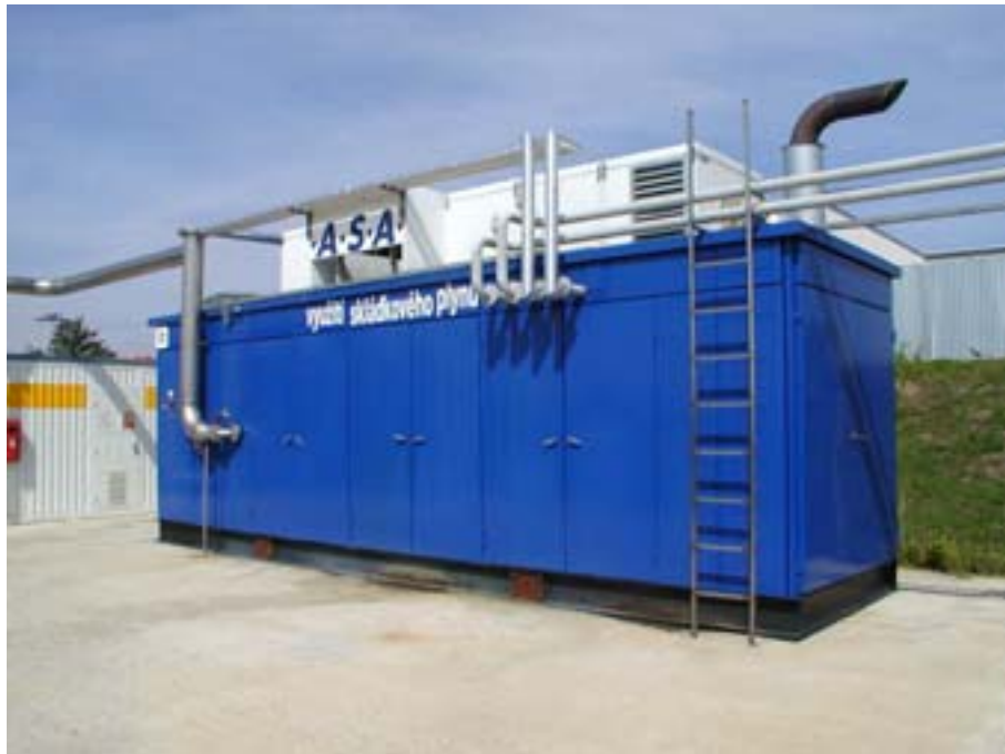
Obr. 5.7: Kontejner s kogenerační jednotkou, v pozadí vlevo objekt čerpací stanice
