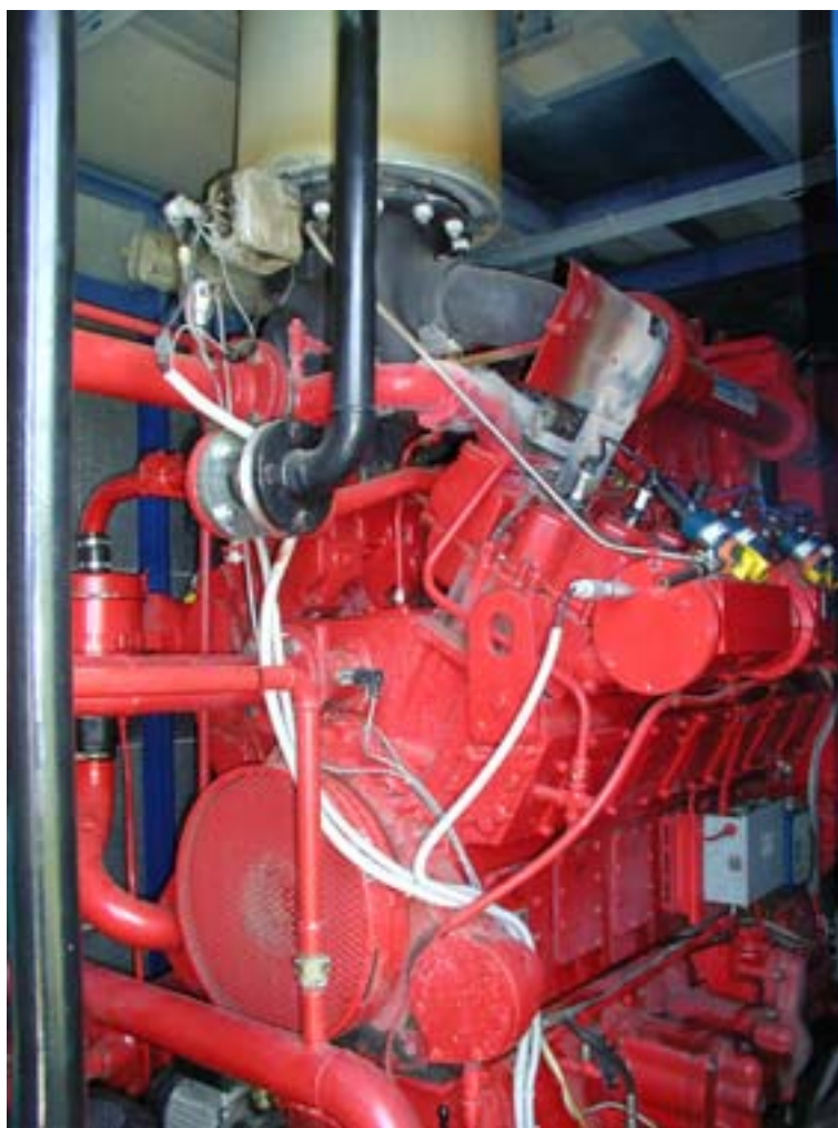
Obr. 5.8: Plynový motor kogenerační jednotky
